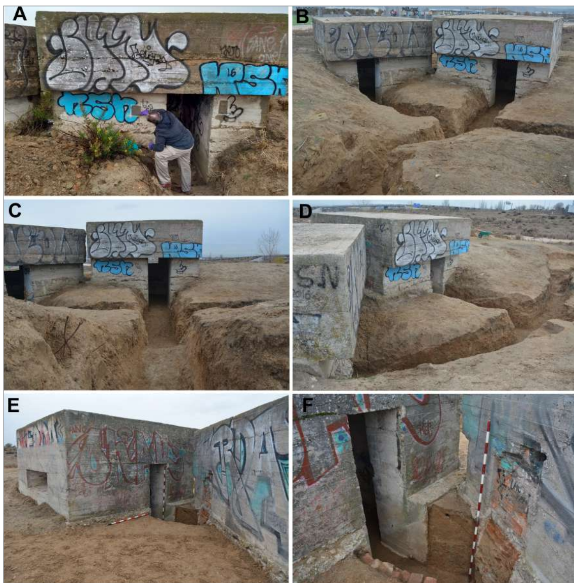
Figura 3. A: pruebas con decapantes. B, C, D: vistas de las trincheras nº 2 y nº 3. E, F: trinchera de conexión. Nótese que el acceso del fortín nº 2 se encuentra sellado con ladrillos.
