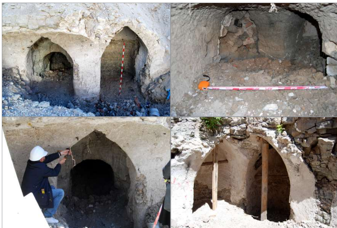
Figura 2. De izquierda a derecha y de arriba abajo, Sierra Gorda c/v Serranía de Ronda: Documentación de los restos existentes al comienzo de la intervención arqueológica, con las obras avanzadas (sibil 12 y galería 11); interior de la galería de desagüe o ventilación (galería 11), en su tramo final, bifurcada y cortada por la construcción del edificio contiguo; toma de muestras para su análisis en la Escuela de Arquitectura de la Universidad Politécnica de Madrid; apuntalamiento de los sibiles conservados antes de su colmatación para su conservación bajo la calle Serranía de Ronda
