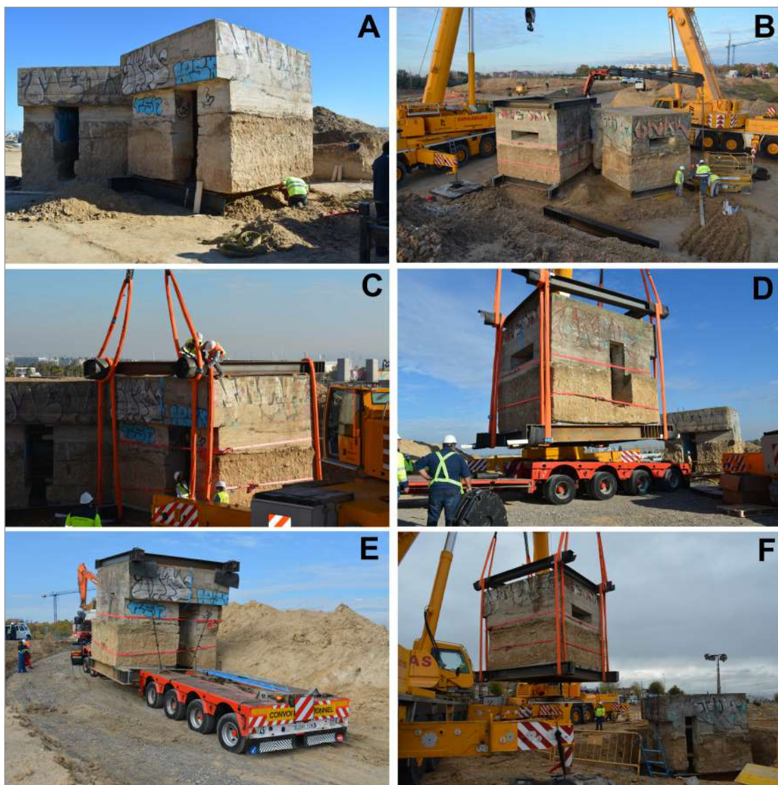
Figura 7. A: instalación de marcos metálicos bajo las cimentaciones. B y C: instalación de marcos superiores y eslingas. D: izado del fortín nº 1 hacia la góndola. E: traslado del fortín nº 1. F: colocación de fortines en su situación definitiva.
